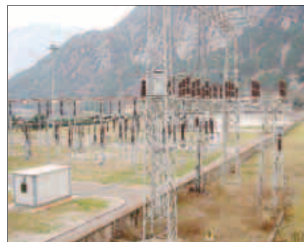
La stazione elettrica della centrale di Santa Massena
