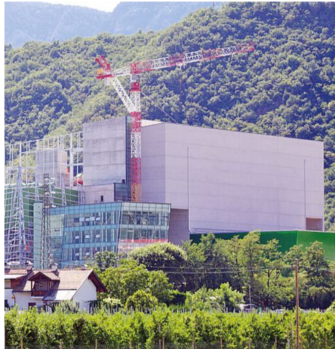
Il nuovo inceneritore in fase di costruzione a Bolzano: nel mirino di Nimby
